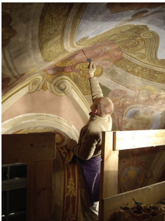
Autor w trakcie prac – przęsło centralne / Author at time of works – central severy
